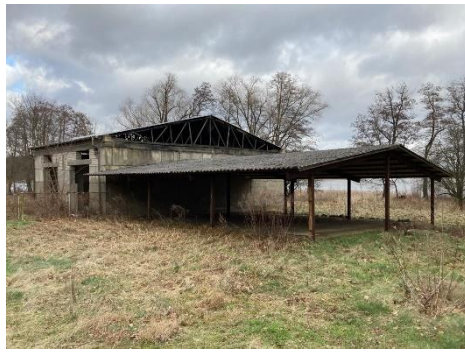
Abb. 23: Ruinöse Bebauung östlicher Uferbereich
