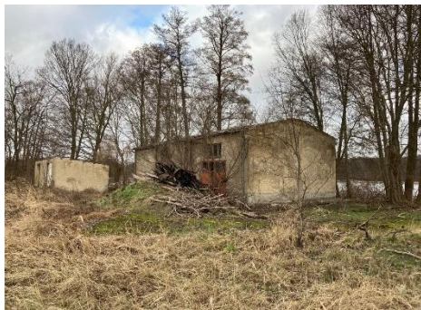
Abb. 24: Ruinöse Bebauung nordöstlicher Uferbereich
