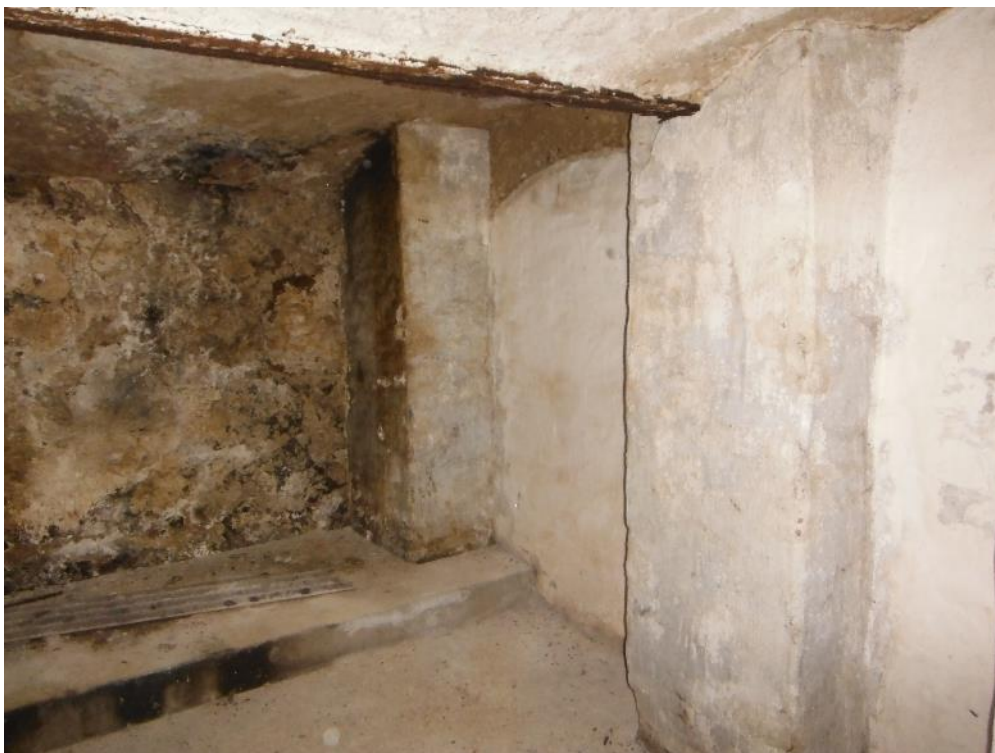
Abb. 21: Nische im Keller des Heizwerks mit Hinweis auf einer Fledermauslebensstätte
