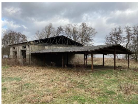
Abb. 23: Ruinöse Bebauung östlicher Uferbereich
