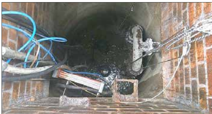
Pumpwerk von innen (4 m tief) alt
