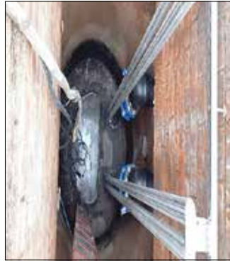
Pumpwerk von innen neu Bilder: Quelle TAZ
