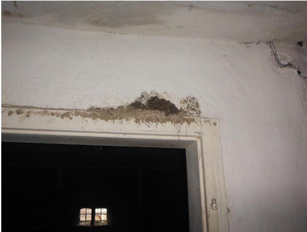
Abb. 18: Reste eines Rauchschwalbennests in der ehemaligen Stanze
